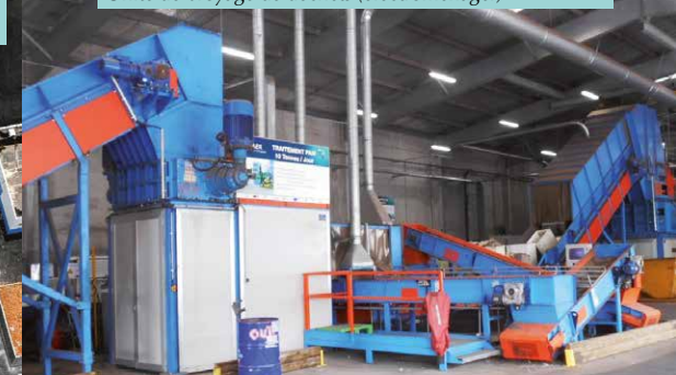
Unité de broyage de déchets (électroménager)
