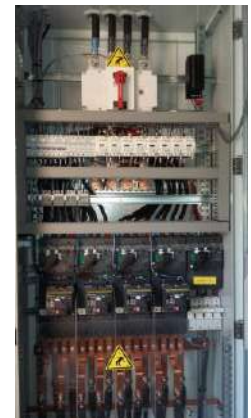
Disjoncteurs BT manœuvrable
