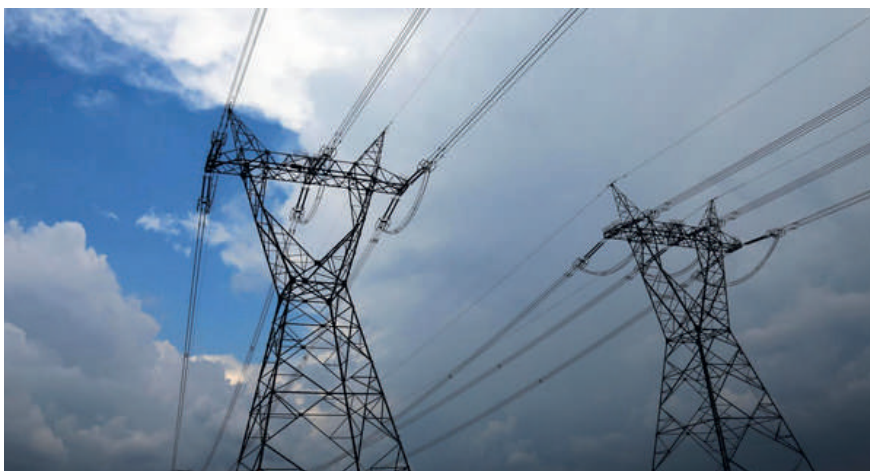
Lignes haute tension. Crédit Photo : EDF Archipel Guadeloupe
