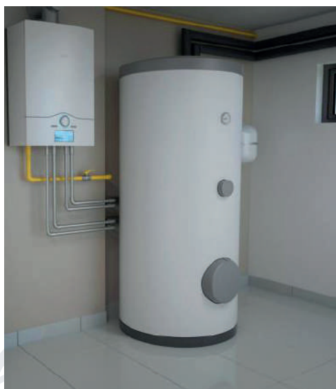
Chauffe-eau thermodynamique, crédit photo : Elite Ecologie.
