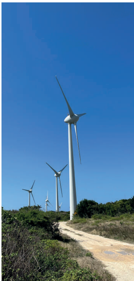
Site éolien, Petit Canal. Crédit photo : Synergiles.
