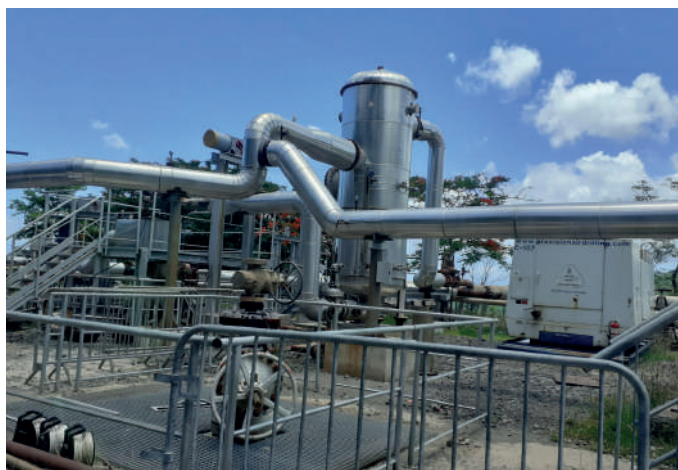
Puits de production d'électricité géothermique, Bouillante. Crédit photo : Synergiles.
