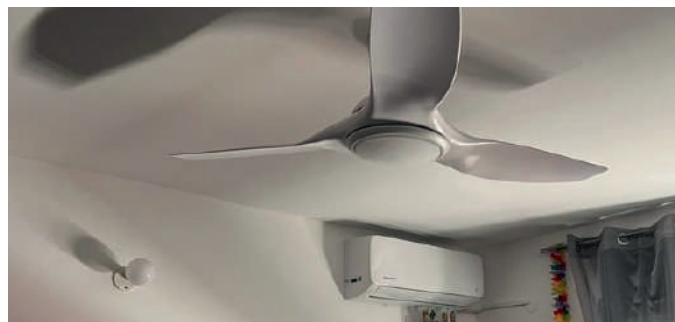
Pièce équipée de climatiseur performant et de brasseur d'air. Crédit photo : outremer la 1ere
